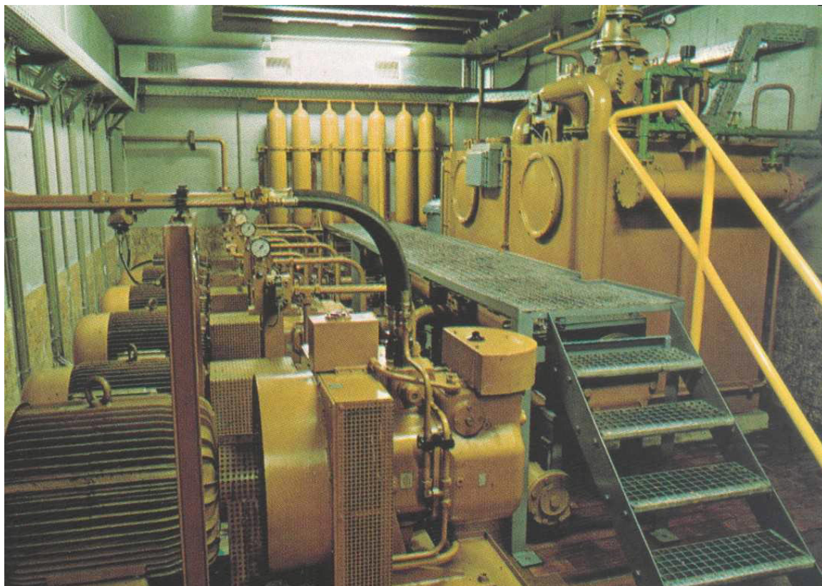
Obr. 7.1 Pohled do sklepa hydrauliky: vpravo nádrž, vlevo řada pohonných jednotek, vzadu akustanice (ŽĐAS)
