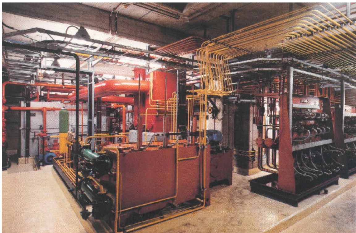
Obr. 7.2 Pohled do sklepa hydrauliky: panely a potrubní rozvody (ŽĐAS)
