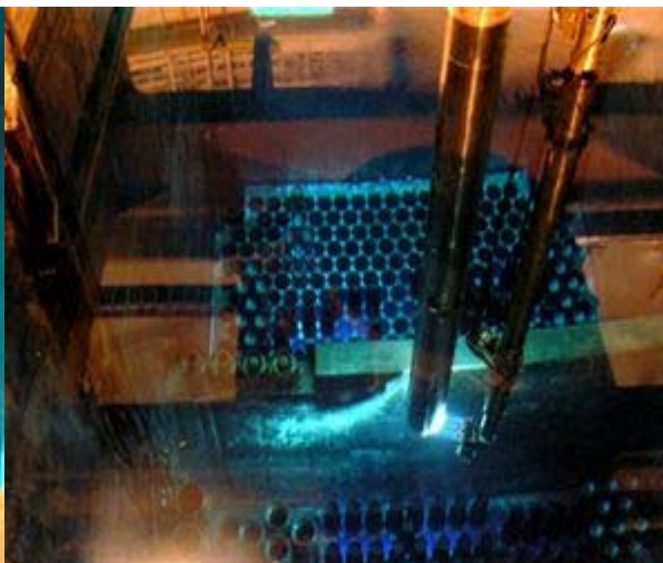
Obr.44. Bazén s vyhořelým palivem
