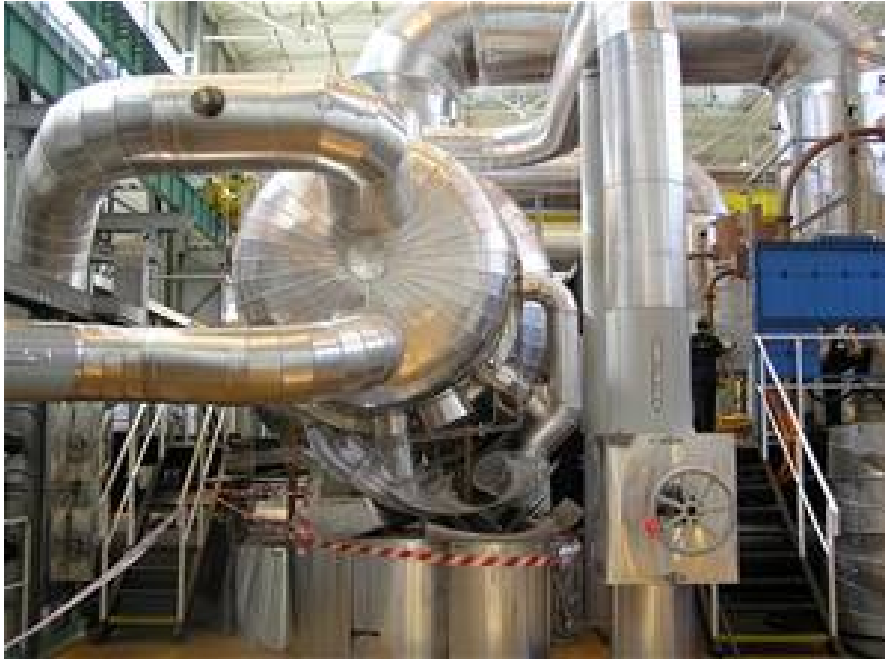
Obr.52. Separátor a přehříváč
