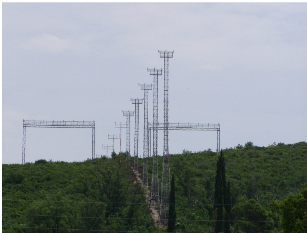
Obr. 3.6 Letiště Dubrovnik – reálné provedení naváděcích světél
