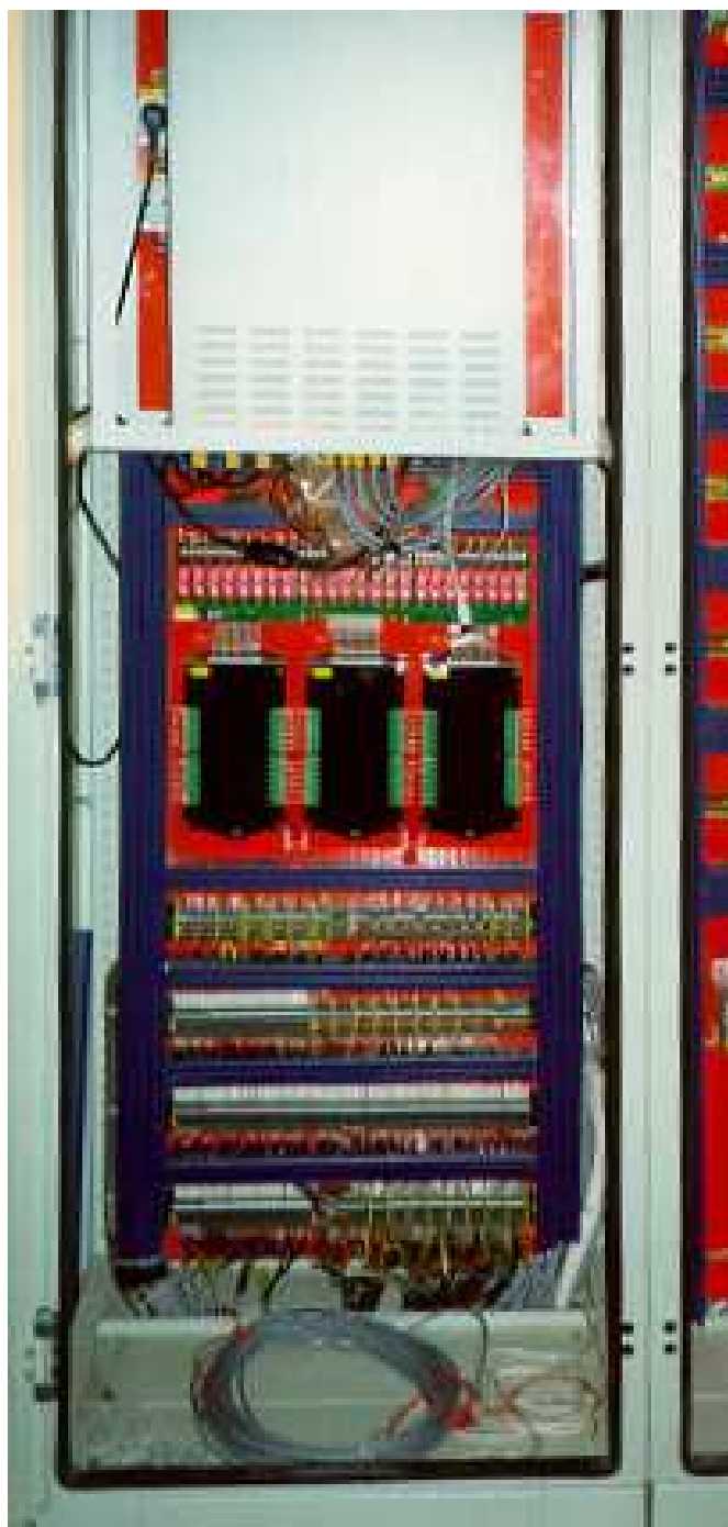
Obr. 7.5 V horní polovině kovového rozvaděče – umístěného v prostoru hydraulické stanice v Obecním domě – je skříň IPC. V jeho dolní části jsou zakončovací panely (řada červených modulů polovodičových relé a tři tmavé panely optooddělených binárních vstupů). V pravé části rozvaděče jsou umístěny stykače, výkonová relé, spínané zdroje apod.
