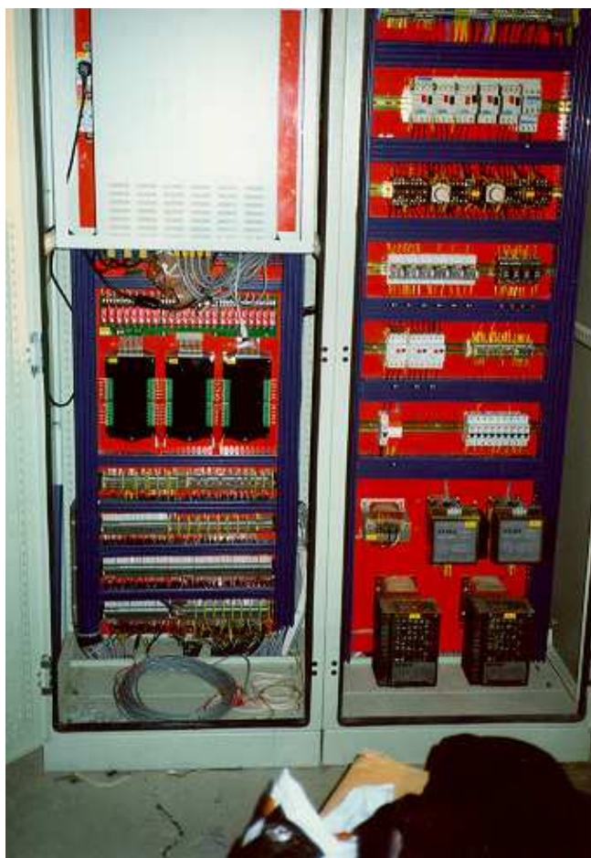
Obr. 4.8 V levé – oddělené části plechového rozvaděče je v jeho horní polovině skříň IPC. V jeho dolní části jsou zakončovací panely (řada červených modulů polovodičových relé a tři tmavé panely optooddělených binárních vstupů). V pravé části rozvaděče jsou umístěny stykače, výkonová relé, spínané zdroje apod.
