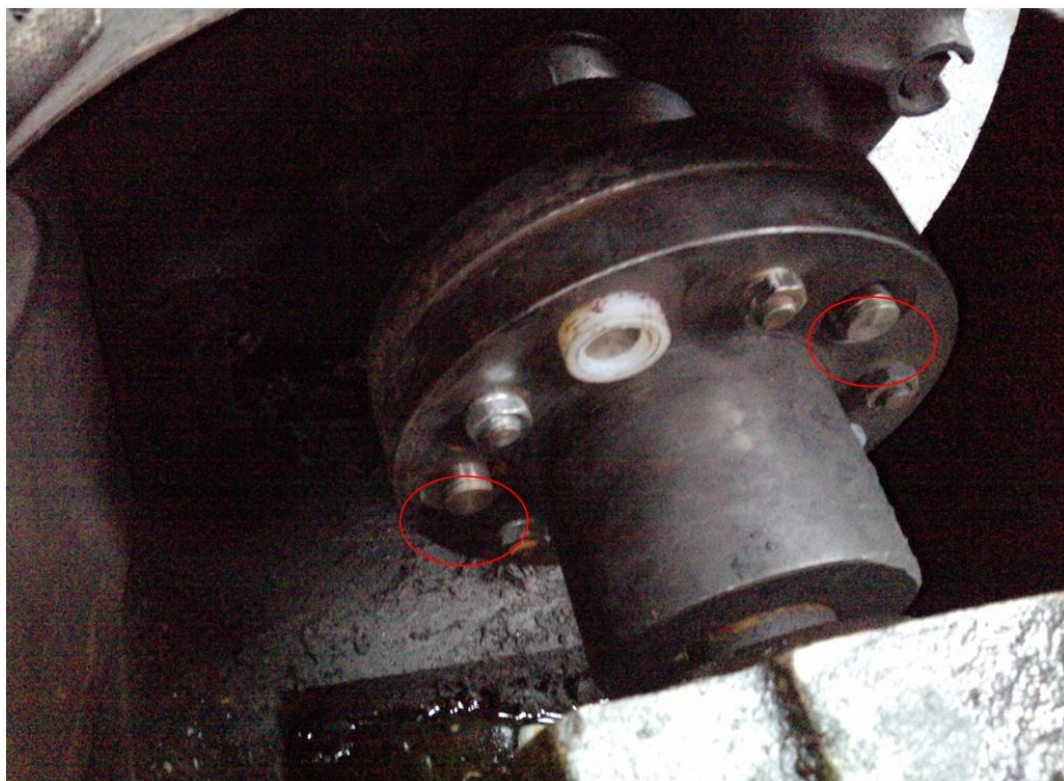
Obrázek 2.14 – Pohled shora na vadnou spojku s vypadanými silonovými kroužky
