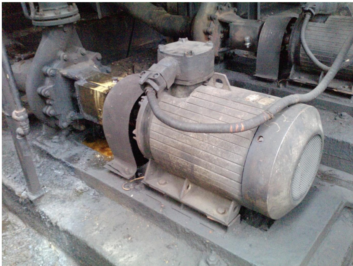
Obrázek 2.1 – Celkový pohled na sestavu jednoho z čerpadel
