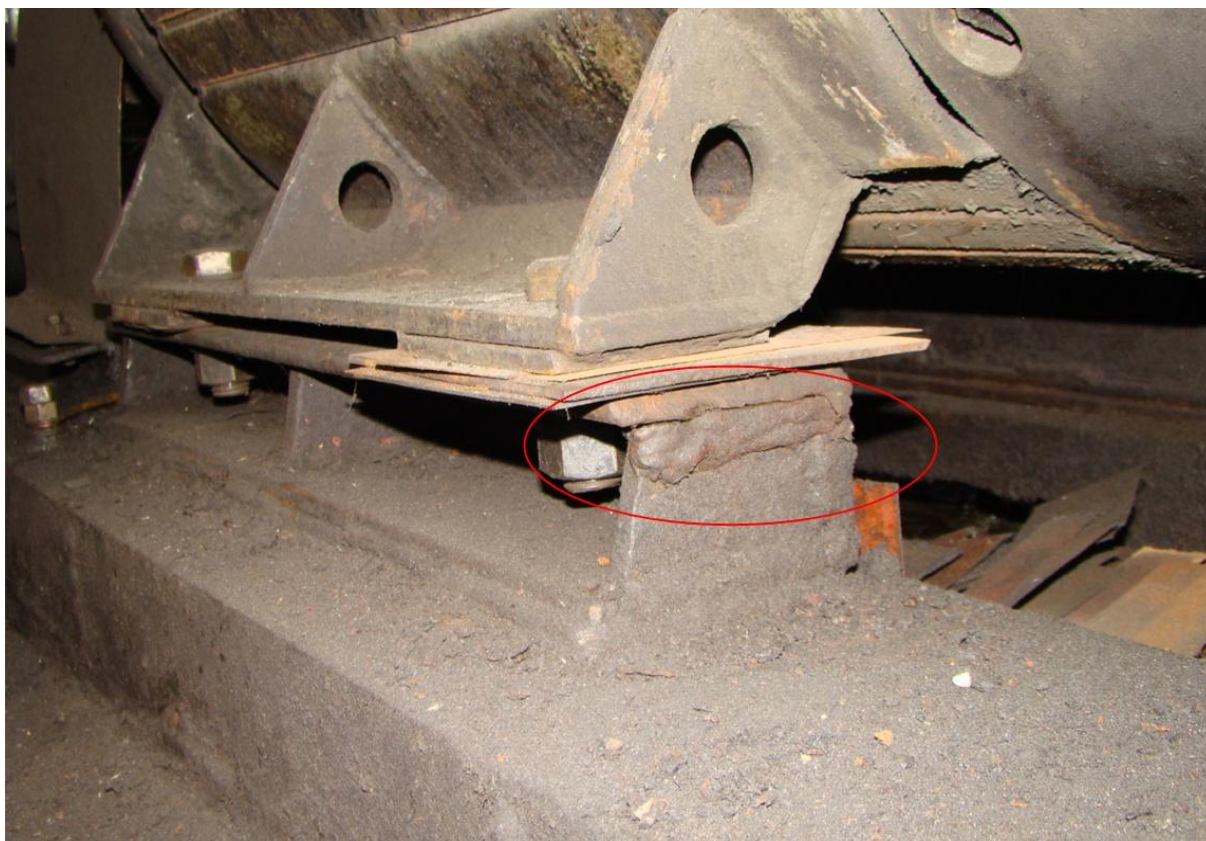
Obrázek 2.5 – Pohled na prasklinu rámu na levé zadní straně motoru (LZ Mot)
